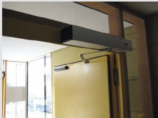
Abb.20: Obenliegender Türschließer u.a. mit Freilauffunktion für das Bedienen mit geringem Kraftaufwand inkl. Einbindung in die BMZ
