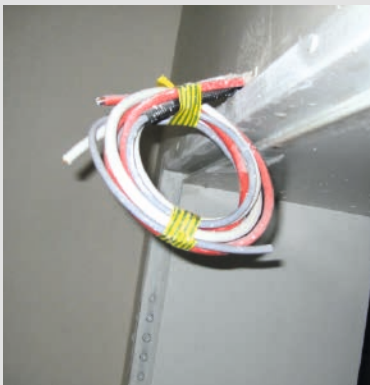
Abb.19: Notwendige Installation für Türschließer mit Einbindung in die BMZ, Brandmeldezentrale
