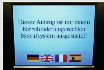
Abb.24: Beispiel zur Erkennung des Notrufsystems eines Aufzugs
