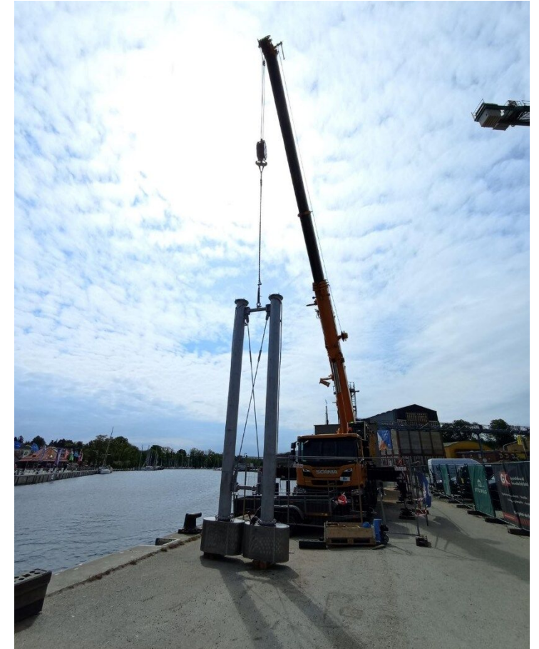
Doppel-Entnahmekonstruktion mit Saugkörben
